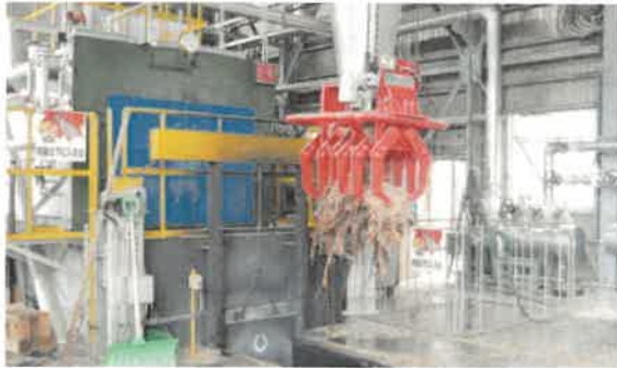
写真1. 工場内部(ボイラー前)
