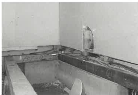
写真3: 在来型A棟の最終破壊状況。土台が水平割裂し、柱列群が一斉に引き抜け浮き上がり。
