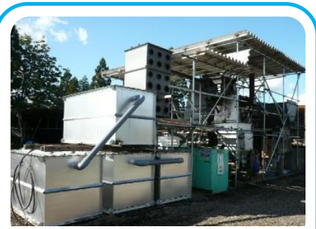
図1 二連式アップドラフト型ガス化発電装置の写真(数字は水槽の番号で、ガスが通る順を示す)
