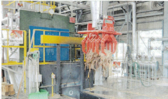
写真1. 工場内部(ボイラー前)
