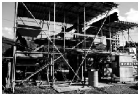
図1 実大木質バイオマスガス化発電システム（秋田県鹿角市に設置）
