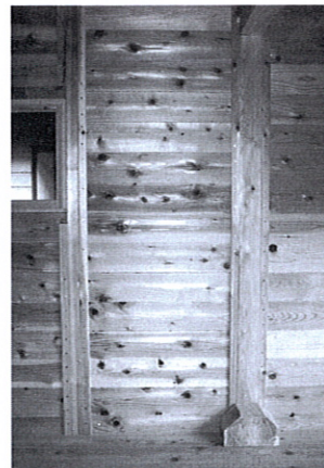
写真6：伝統型C棟の修復状況。添木により柱に縫い付けられた落とし板壁。
