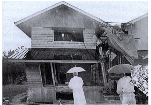
写真2：大加力時の伝統型C棟の変形状況。壁土は剥落するが、軸組がしなやかに大変形を吸収。
