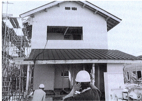
写真1：大加力時の在来型A棟の変形状況。建物全体が浮き上がって回転するが、内外壁と屋根面の立体コアが何とか抵抗。
