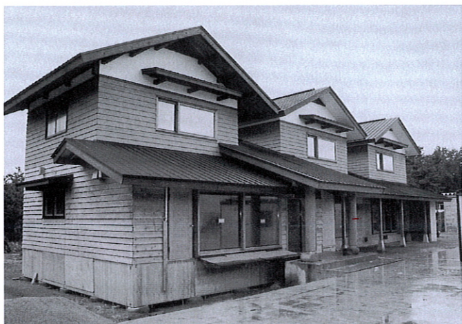
写真7：3棟の実験棟の現況。2階の外装までの工事が完了。B、C棟間に円筒LVL柱が立つ玄関部分を増築。A、B棟間の下屋を繋ぎ、雪国特有の「土縁」の設営を予定。
