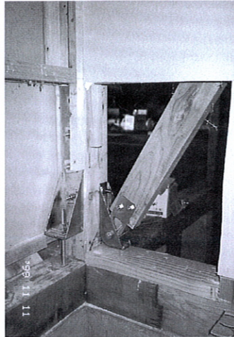
写真5：在来型A棟の修復状況。ホールダウン金物によって柱を基礎へ直接縫い付け。筋かい端部へスチール接合金物を挿入。
