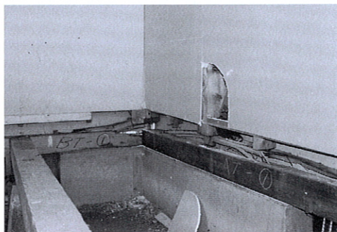
写真3：在来型A棟の最終破壊状況。土台が水平割裂し、柱列群が一斉に引き抜け浮き上がり。
